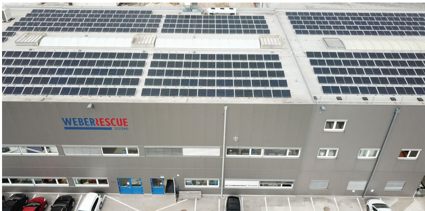
Photovoltaik-Anlage mit 364 kWp installierter Leistung
